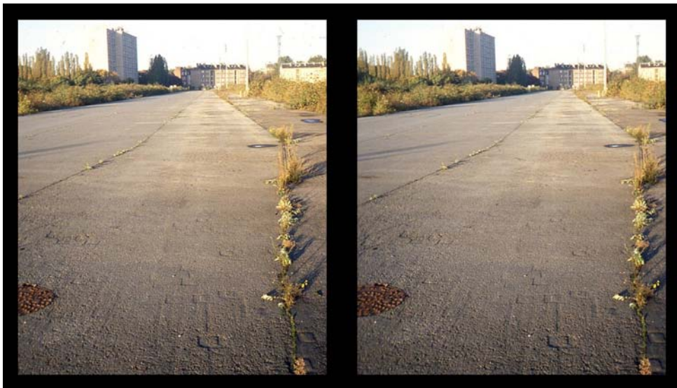
2 - Cour marchandises de la gare de Lille-Saint-Sauveur : désaffectée depuis 2003 (photo de 2010), ce lieu est encore en 2021 à l'état de friche ; de nombreux projets existent mais pas encore décidés.
