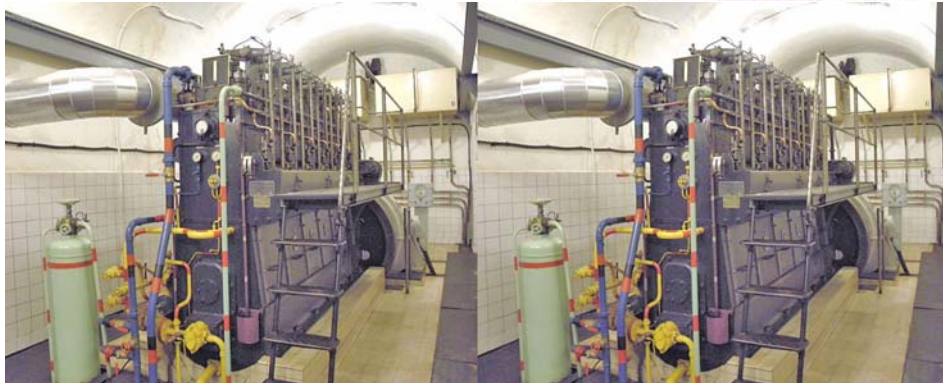
Les moteurs des groupes électrogènes de ce poste de la ligne Maginot mesurent environ 3 mètres de hauteur, il y en a quatre et les réserves en carburant sont de plusieurs dizaines de milliers de litres. - Photo : Jacques Sandillon
