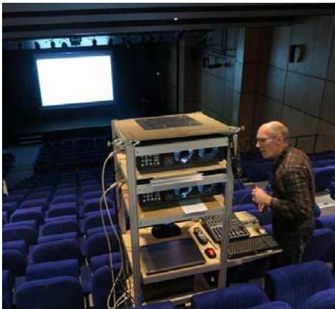
Les projecteurs Panasonic en position inversée pour une projection en fond de salle et une disposition en gradins.
